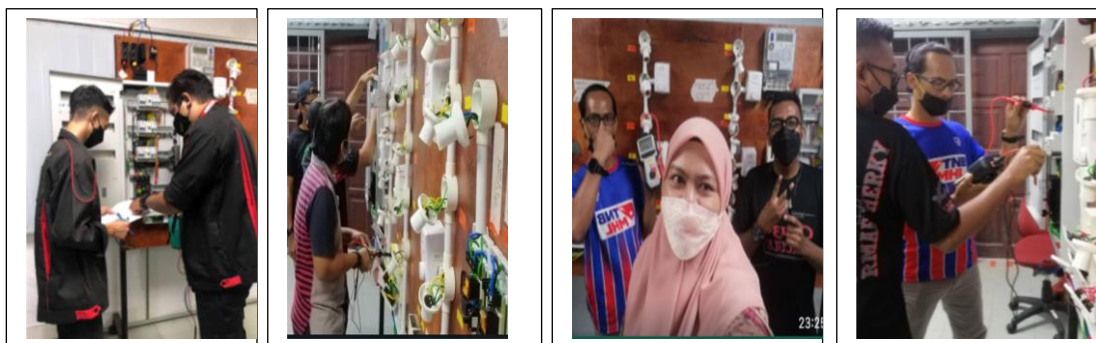
Rajah 4: Pelajar melakukan Pemeriksaan dan Pengujian pada Panel Pendawaian Elektrik
